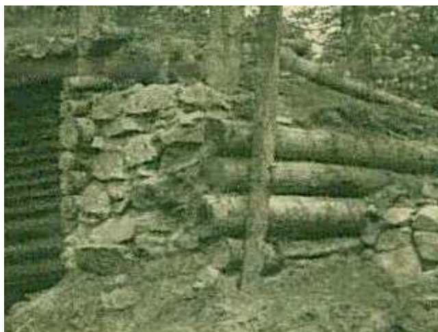
Obr. 4/2: Detail zesílené boční stěny úkrytu
